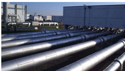
Gassmålerør ved mottaksterminalen i Dornum i Nord-Tyskland. Dornum er landfallet for Europipe I- og II-rørledningene.
