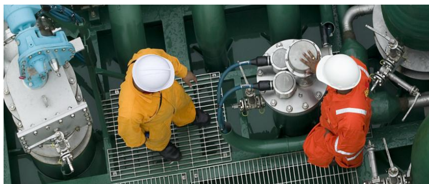
Instrumentering på tanktopp for måling av nivå og temperatur.
