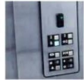
Inspeksjon av heiser (NS-EN ISO/IEC 17020)
