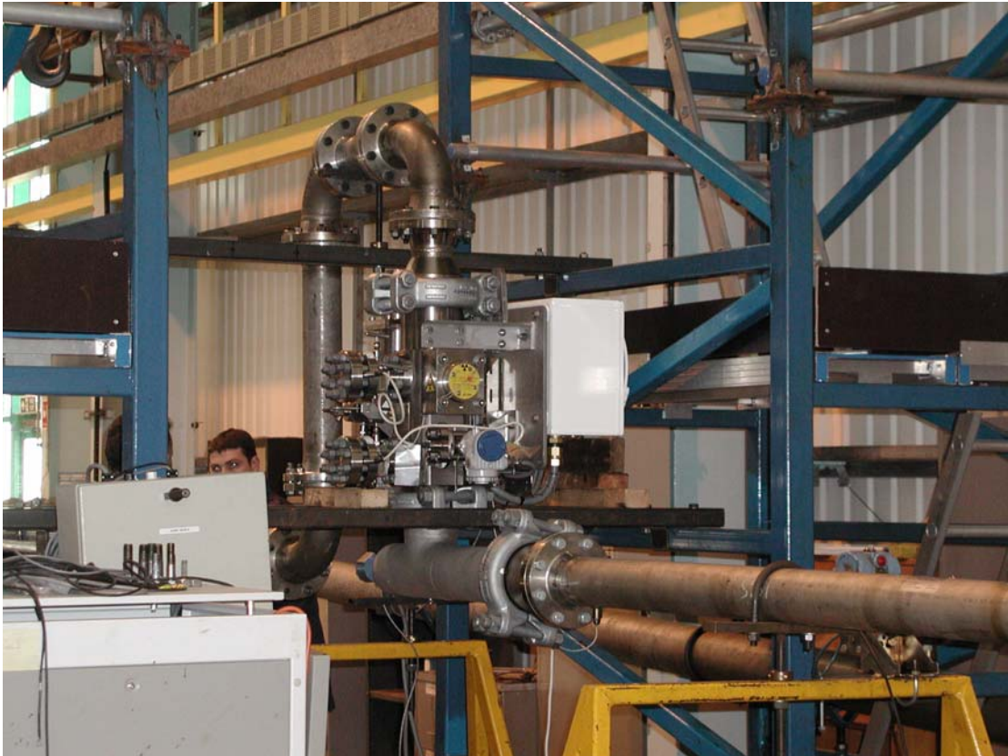
Figure 3 Maclure MPM Installed at NEL
