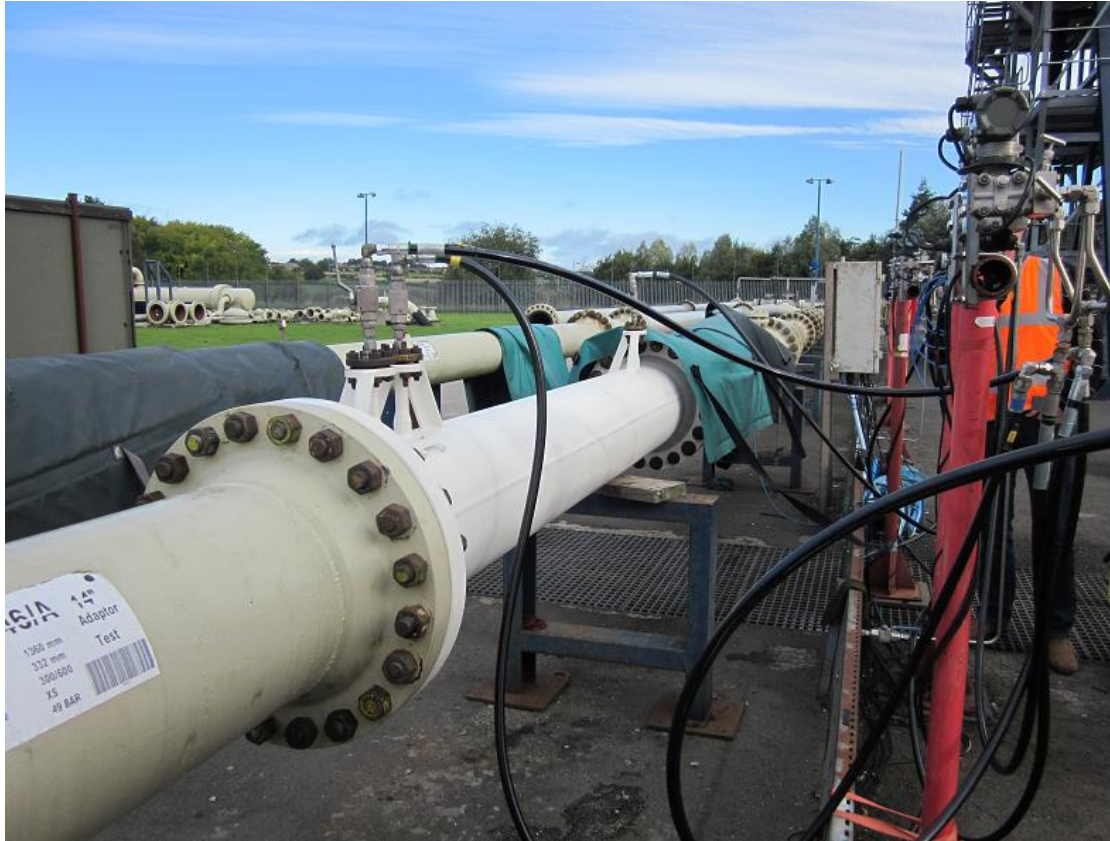
Fig. 11 - 14" Cone DP Meter Under Test
